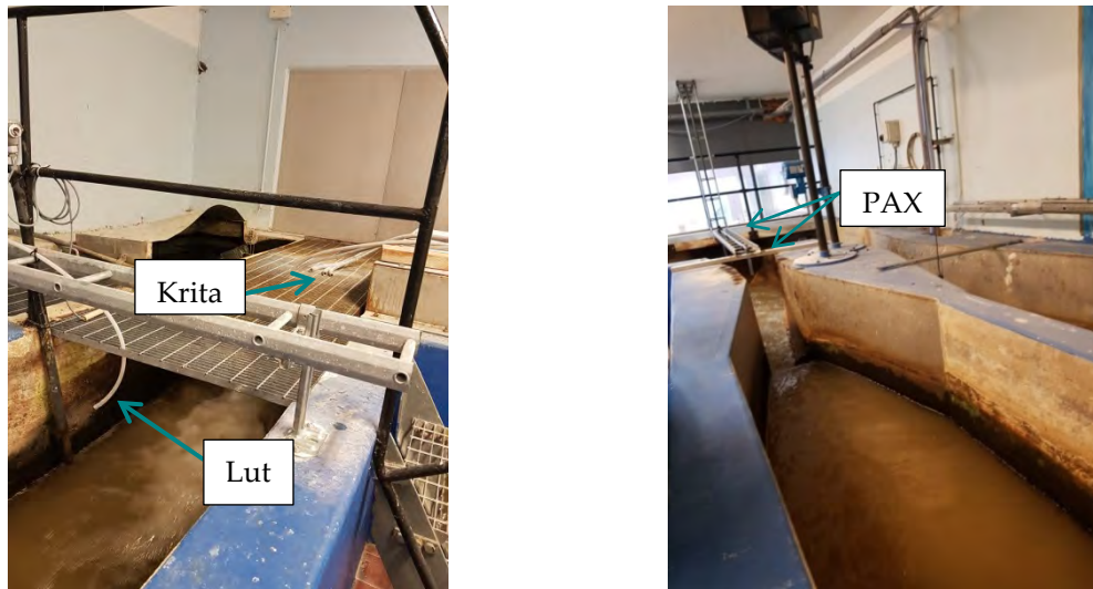
Figur 3. Dosering av krita och lut (vänstra bilden) och fällningskemikalie (högra bilden) i inloppsrännan.
